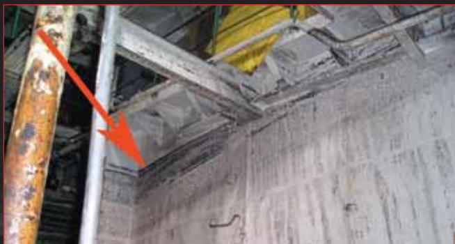
Следы от аварийной воды (осадка около 6,5 м, крен около 20°) на носовой переборке 125 шп. помпового отделения з/с «Черное море»
