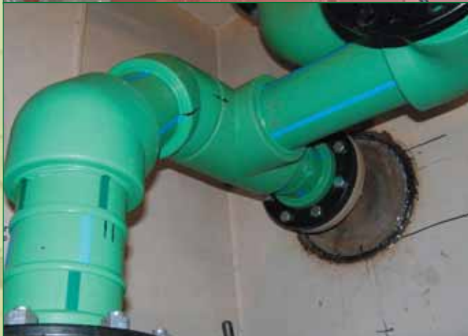
«Генерал Трошев»: переборочные проходки для пластмассовых трубопроводов
