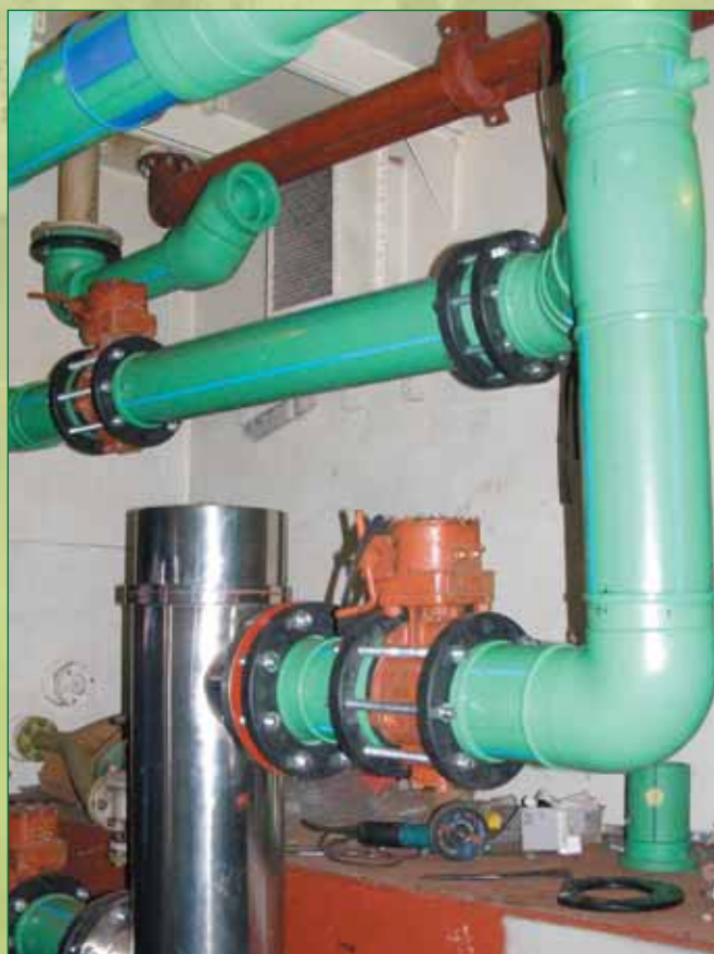
Пластмассовые трубы установки УФ-обеззараживания забортной воды, заказ № 616
