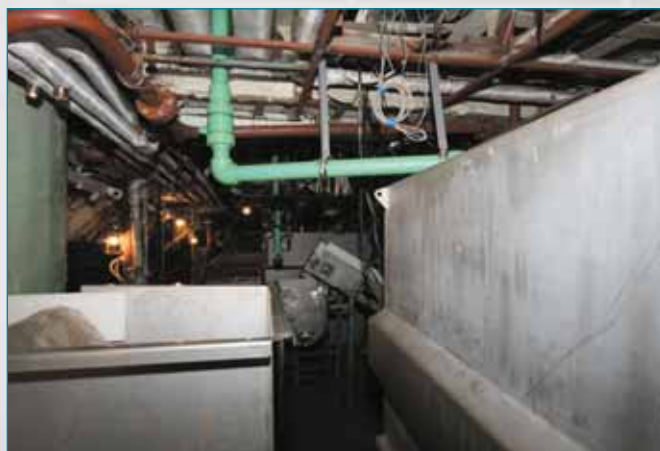
В рыбообрабатывающем цехе установлены пластиковые трубопроводы
