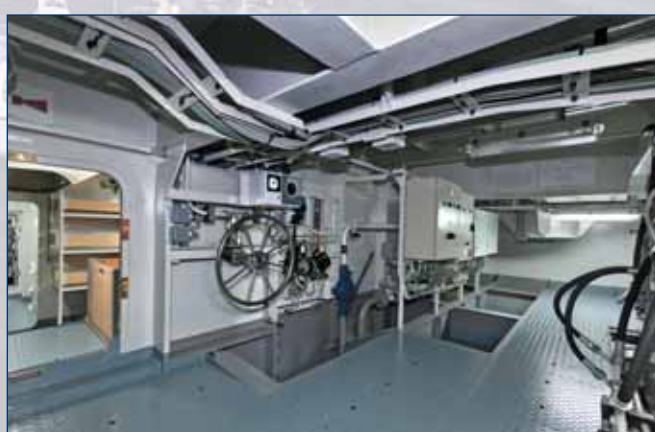
Резервный пост управления в румпельном отделении
