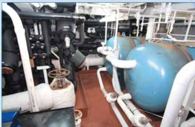
Ресиверы холодильных машин
