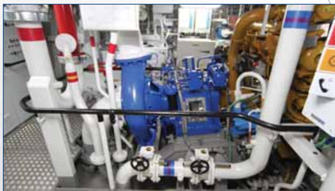
Пожарный насос на 1300 м³/ч с приводом от главного двигателя
