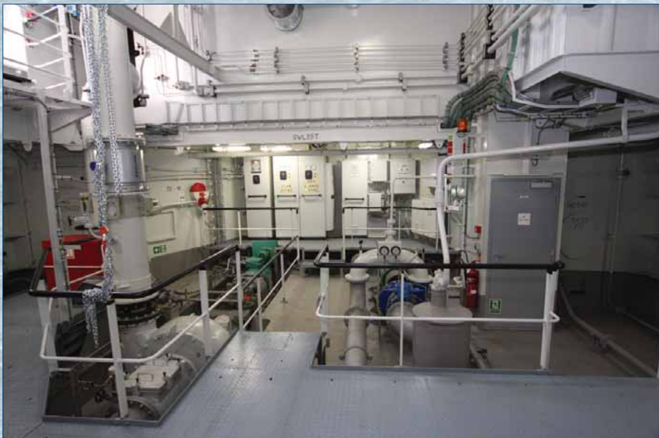
Насосное отделение Damen HD 750. На переднем плане слева — грунтовой насос судна, справа — агрегат водометного подруливающего устройства
