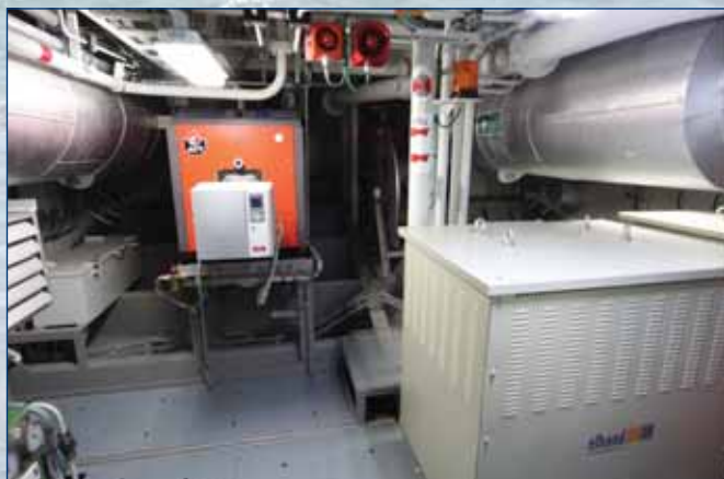
Ахтерик «Меотиды»: по бокам — глушители ДГ, в центре — водогрейный котел ACV Cotract бельгийского производства
