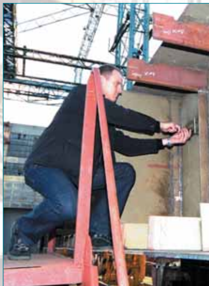
Потомственный корабельщик Виктор Трубац устанавливает памятную табличку на закладной секции первого танкера пр.RST27
