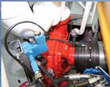
Центробежный насос специальной водопожарной системы
