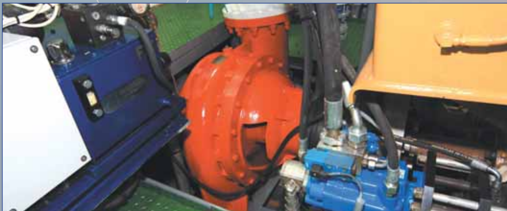
Пожарный насос с приводом от правого главного двигателя
